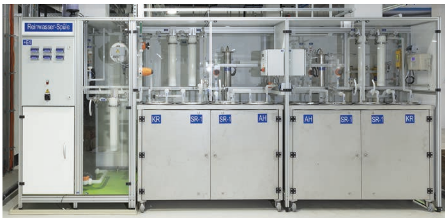
Ein Teilsegment der neuen Reinstwasser-Aufbereitungsanlage
