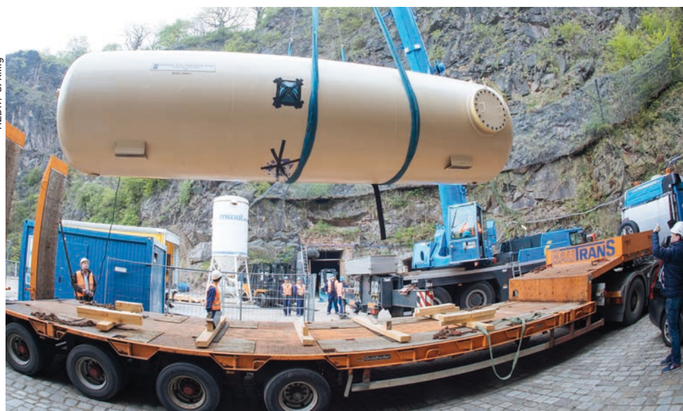
Bereits Ende April wurde der acht Meter lange und zehn Tonnen schwere Beschleunigertank angeliefert.
