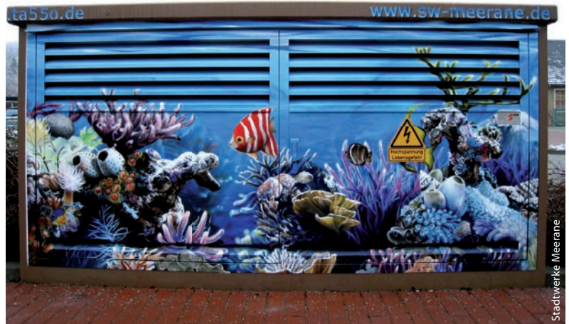
Trafostationen verändern sich: außen mitunter künstlerisch verschönert, innen mit „intelligenter“ Technik wie regelbaren Ortsnetztransformatoren ausgestattet.
