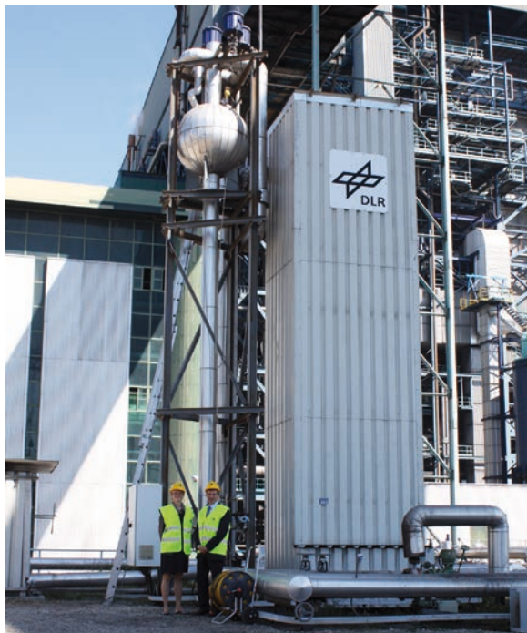
Abb. 1 Mit den 14 Tonnen Natriumnitratsalz dieses weltgrößten Latentwärmespeichers lassen sich 700 kWh thermischer Energie bei 300°C speichern. Der Speicher wurde in ein Dampfkraftwerk im spanischen Carboneras integriert und absolvierte dort erfolgreich hundert Zyklen. Solche Konzepte eignen sich besonders für solarthermische Kraftwerke mit Direktverdampfung.
