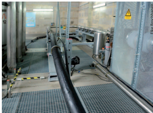
Das weltweit längste Supraleiterkabel wurde offiziell in das Essener Stromnetz integriert und verbindet für den Testbetrieb zwei Umspannanlagen.
