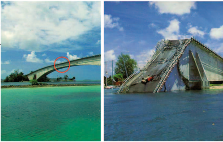
Abb. 5 Die Brücke zwischen Koror und Babelthup in Palau sackte nach einer Reparatur vermutlich aufgrund nichtlinearer Kriech-Effekte um einige Meter ein (links markiert), bevor sie schließlich komplett einstürzte.
