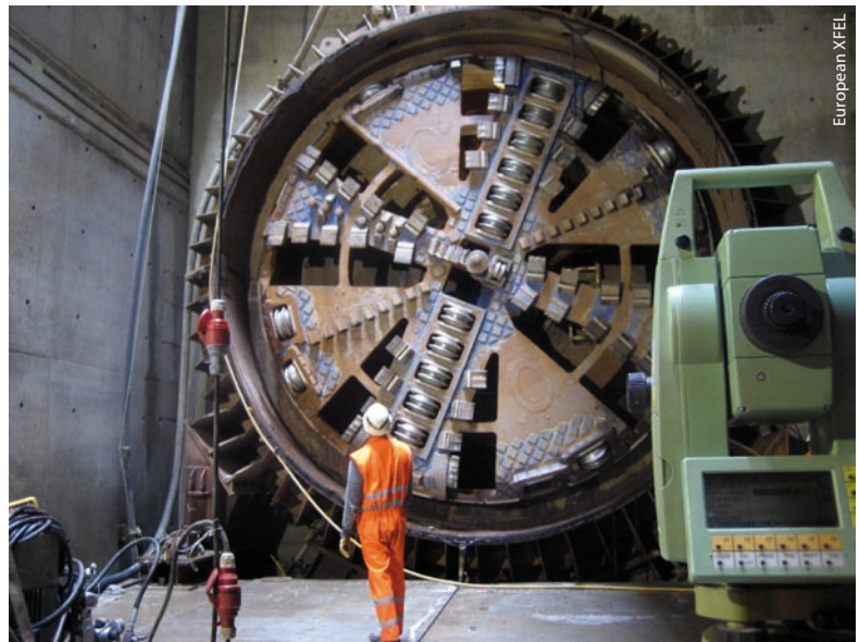
Mit der Tunnelbohrmaschine TULA, deren Schneidrad einen Durchmesser von sechs Metern hat, wurde Ende Juli
