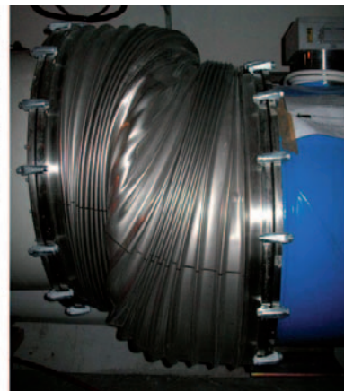
ganze Magnete gegeneinander versetzt und die Verbindungen schwer beschädigt wurden.
