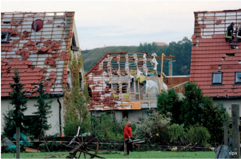
Abb. 12 Im thüringischen Quirla richtete ein Tornado am 2. Oktober 2006 erhebliche Schäden an.
