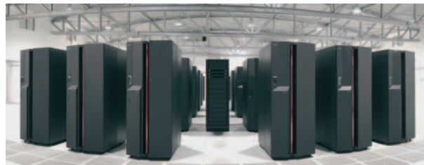
Der neue Supercomputer befindet sich in einer eigenen Halle. Zur Kühlung wird die gesamte Raumluft, rund 6500 Kubikmeter, 38-mal pro Stunde umgewälzt. (Foto: FZ Jülich)
