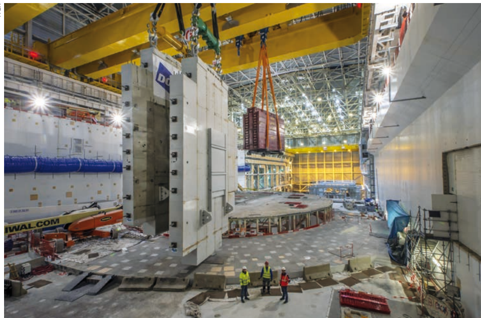
Mit dem Transport zweier knapp 1000 Tonnen schweren Testlasten von der Assembly Hall zum Tokamak Building und zurück wurde der 50. Meilenstein beim Aufbau des Fusionsexperiments ITER erfüllt.
