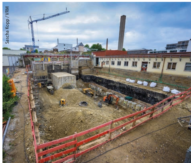
Abb. 6 Blick in die Mainzer Baugrube – hier entsteht die neue Experimentierhalle für MESA. Der große Betonklotz ist der Strahlfänger des Beschleunigers MAMI. Dort wird künftig auch der Elektronenstrahl des MESA-Beschleunigers enden.
