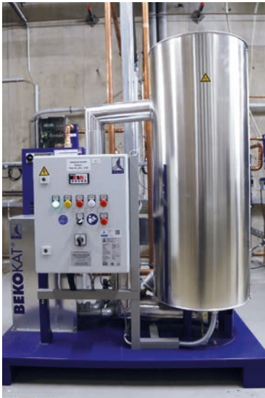
Der katalytische Konverter Bekokat entölt die Druckluft, welche die Inspektionskamera bei einem Kaffeeröster vor Verschmutzung schützt.
